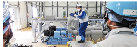
ALPS処理水移送ポンプの確認状況
