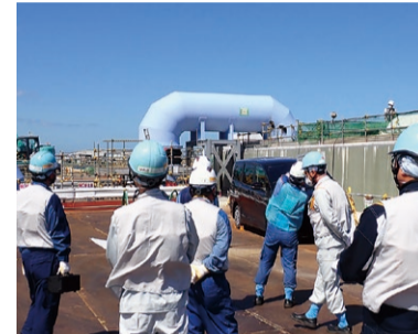
県技術検討会によるALPS処理水希釈放出設備の確認（8月24日）
