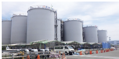
ALPS処理水中の放射性物質濃度を測定するタンク群
